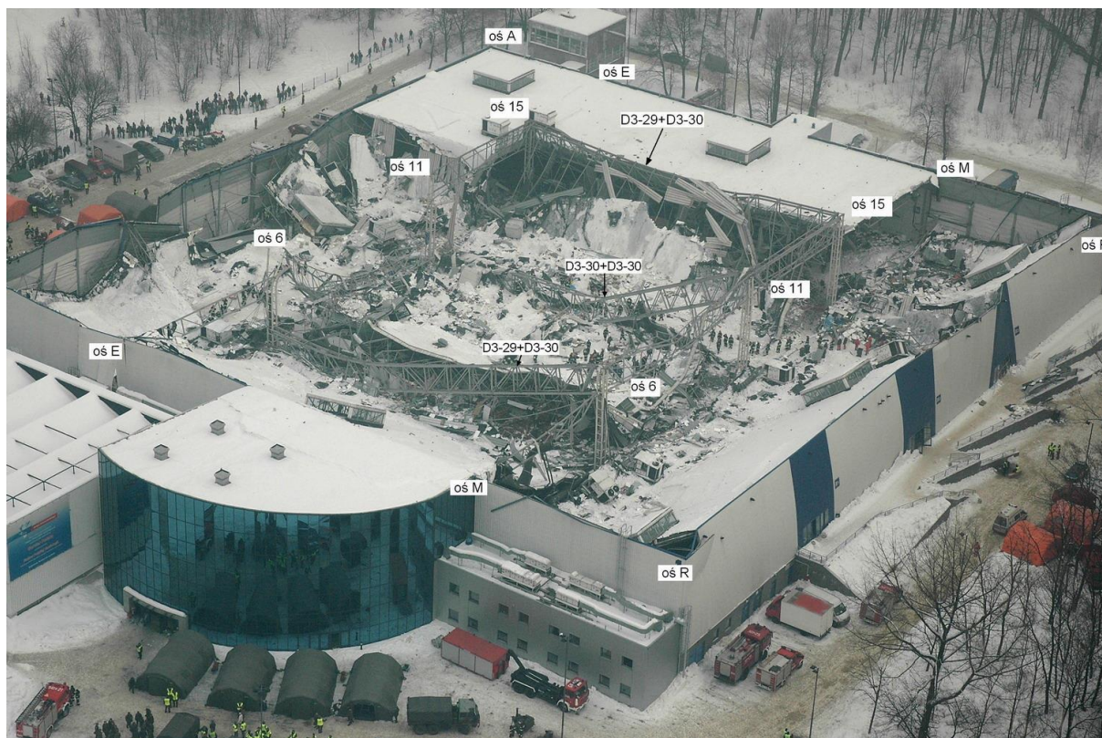
Rys. 41. Widok zniszczenia hali Międzynarodowych Targów Katowickich po katastrofie w 2006 r.
