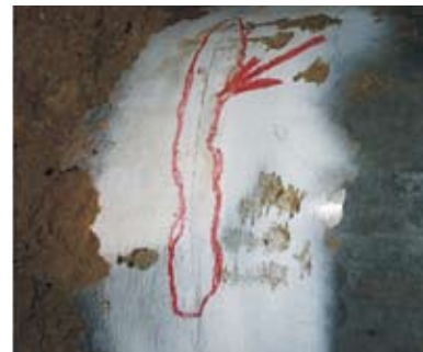
Rys. 1. Obwodowe pęknięcia spoin rurociągu w strefie wpływu ciepła [9, 10]
