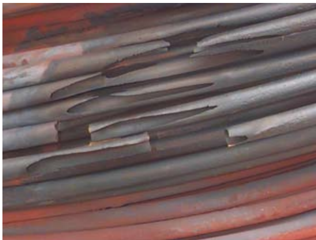
Przykład erozji rur wywołanej wypływem zanieczyszczonego kondensatu z nieostojonego króćca (spływającego kaskadowo z wyższego stopnia regeneracji wysokoprężnej). Konieczna jest zabudowa osłony króćca po wymianie uszkodzonych rur
